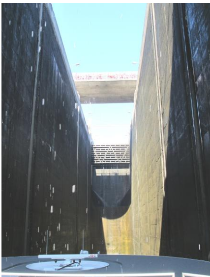
Die 36 Meter hohe Schleuse von Carrapateiro
